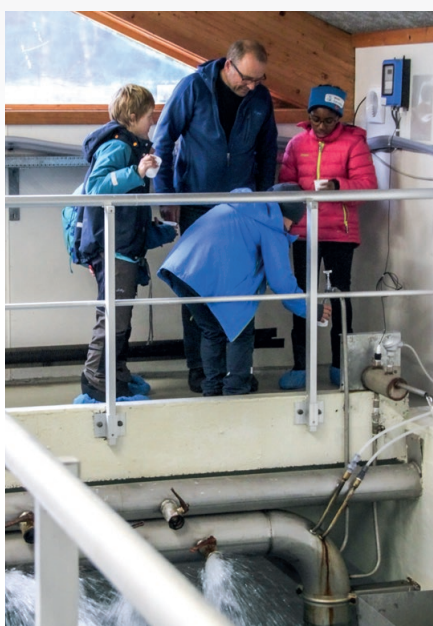
Iver Løken Møllerplass, Lars Rune Eikre og Sissel Komba er med Ingar Nergård og hentar råvatn i luftebassenget på Hemsedal vannverk. Foto: Britt Marie Haraldset Hafsås
